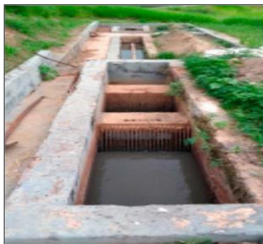
Figura 2 - Vista do Tratamento Preliminar da ETE de Oriente/SP.
