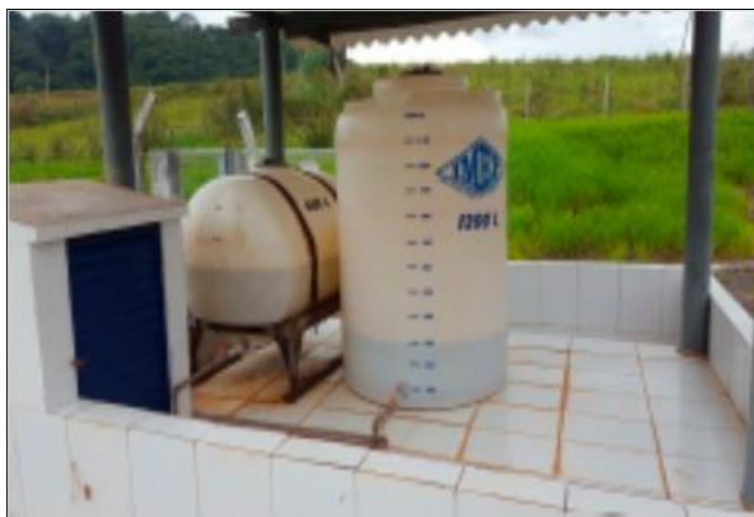
Figura 6 - Vista do sistema de desinfecção por cloro da ETE de Oriente/SP
