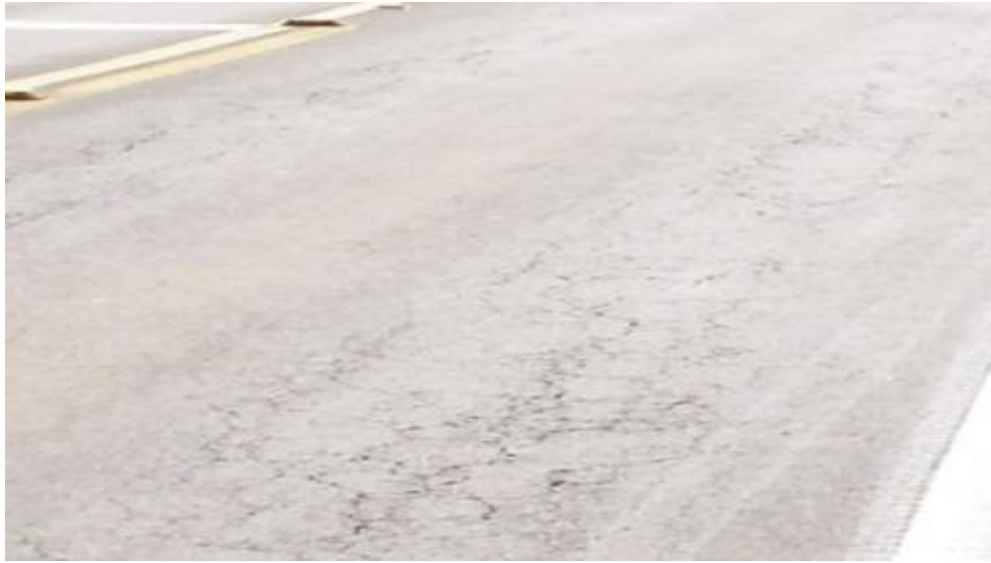
Figura 1- Trecho experimental – BR116/RS – 3anos –Asfalto convencional
