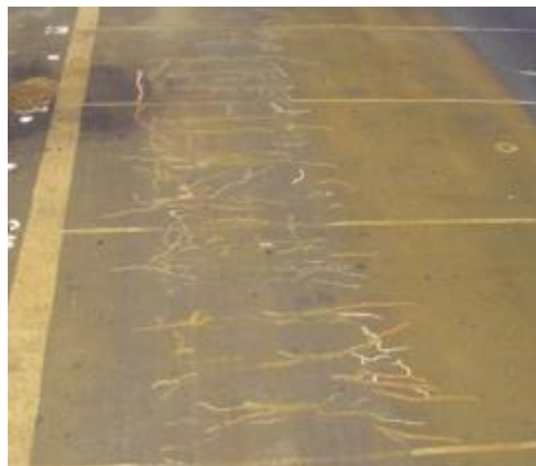
Figura 4- Asfalto convencional em 98000 ciclos
